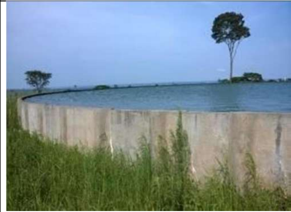
Figura 9. Reservatório de 1MM litros (10.014)
